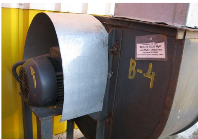
Рис.1.2 – Електропривод механізму радіального вентилятора ВР 288-46-2,5
