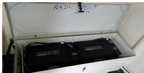
Рисунок 3.3 – Акумуляторні батареї для радіоелектрообладнання
