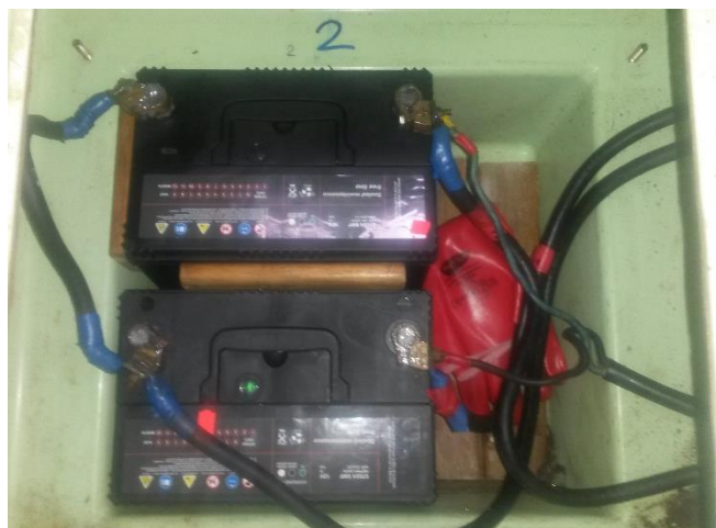
Рисунок 3.2 – Акумуляторні батареї рятувальної шлюпки
