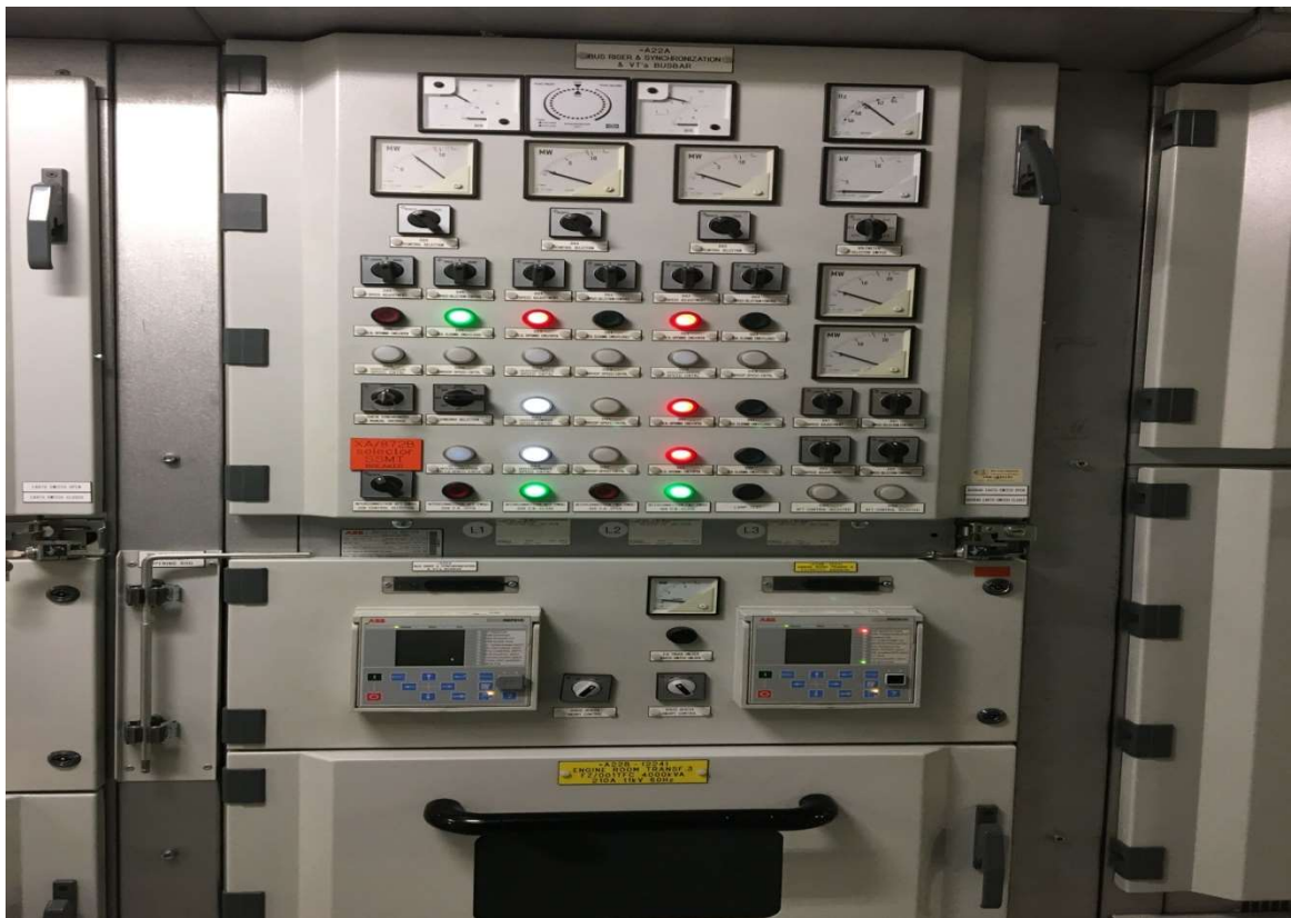
Рисунок 3.3 – Прилади на панелі ГРЩ
