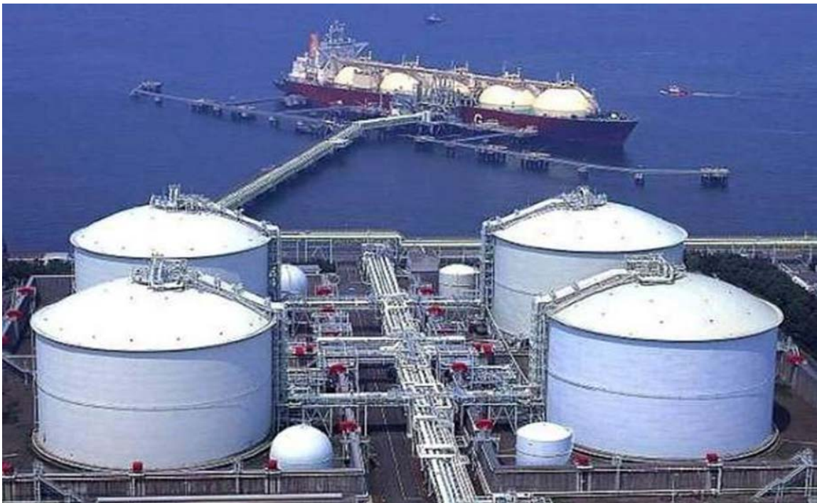
Рис. 3.5. Резервуари для зберігання зрідженого природного газу
